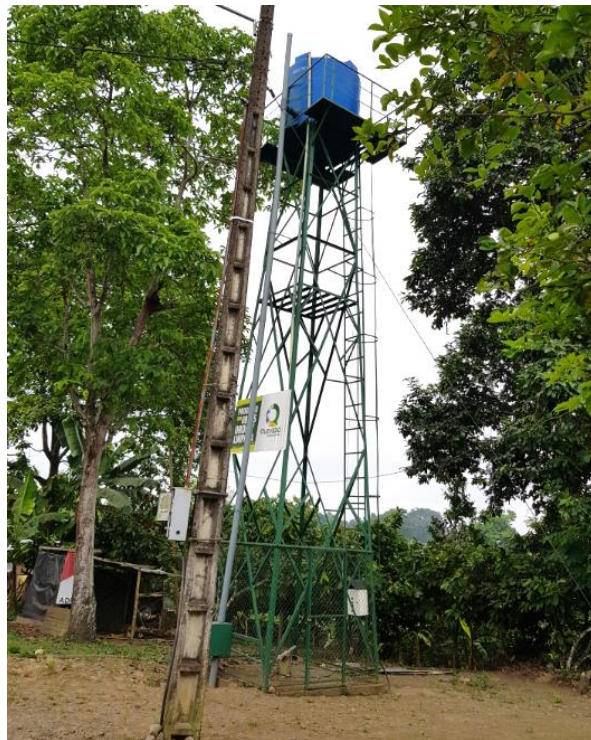
Ilustración 83-Tanque elevado en el recinto Selva Alegre Fuente: Equipo Consultor - 2020
