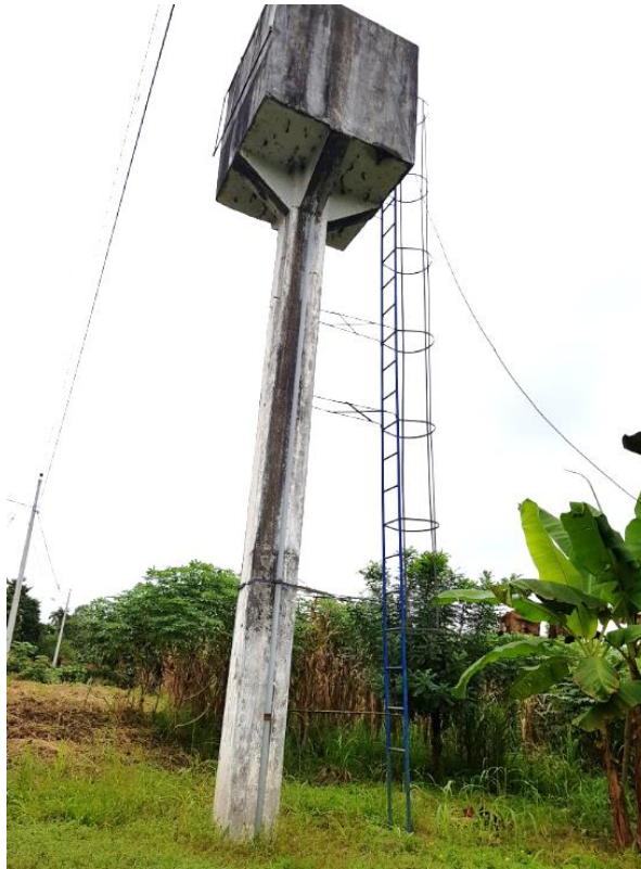
Ilustración 82-Tanque elevado en el recinto Sináí Fuente: Equipo Consultor - 2020
