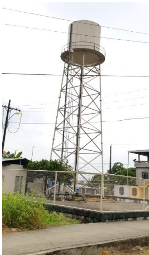
Ilustración 84-Tanque elevado en la Cabecera Parroquial Fuente: Equipo Consultor - 2020
